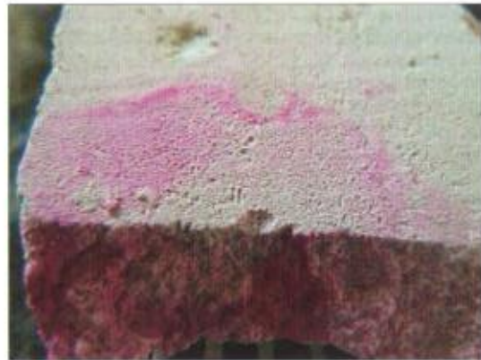
Abb. 4: Kalk-Abbindestörungen am Gips-Kalkputz – obere Putzzone (KIR)
