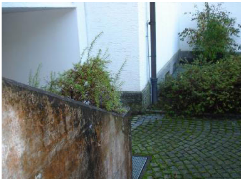
Bild 2: Kath. Kirche Birmenstorf – feuchte Nordwestecke
