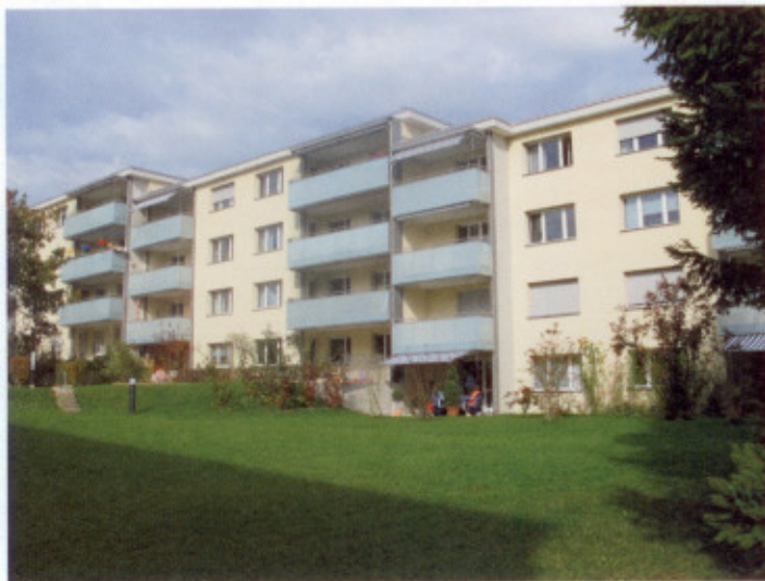
3 Eine WDVS-Fassade mit dickschichtigem System. Mit höheren Schichtdicken reduziert sich das Risiko eines Befalls durch Mikroorganismen.
