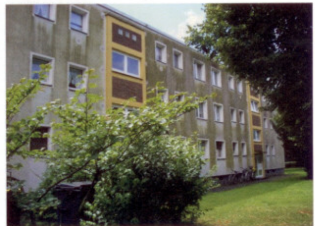
4 Im Gegensatz dazu: Algenbefall an einem dünn-schichtigen WDVS-Aufbau.
